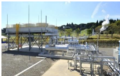
【メディポリス指宿地熱発電所】
