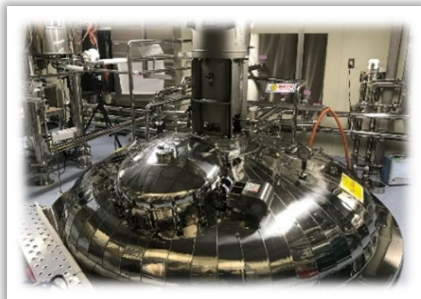
株式会社UNIGENに新設したワクチン生産設備
