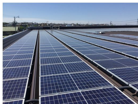
再生可能エネルギー創出・利用へ設置を進める太陽光パネル
