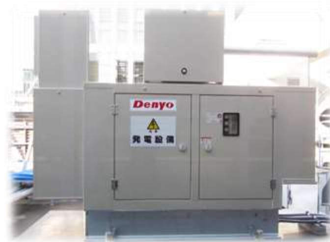
金融機関に設置されたバックアップ用発電機
