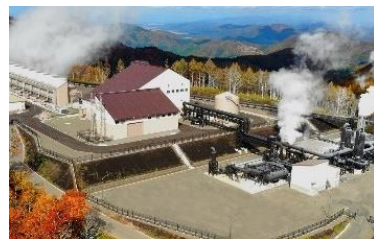
山葵沢地熱発電所 提供: 湯沢地熱(株)
