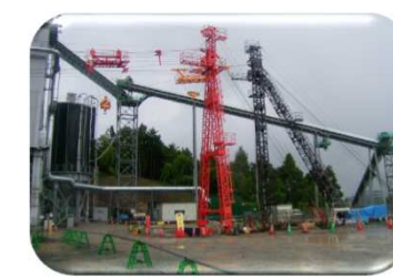
水力発電改修用運搬設備 ケーブルクレーン
