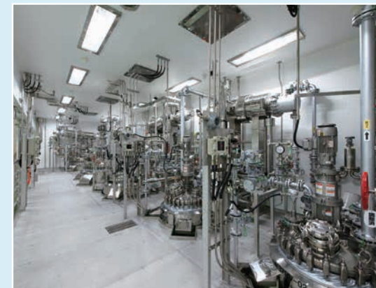
医薬品分野：高薬理活性原薬製造施設
