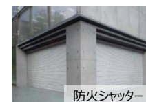
防火シャッター
