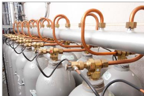
水・泡消火が適さない印刷機械などを有する工場施設、オフィスビル、美術館、博物館、立体駐車場などで活躍するガス系消火設備
