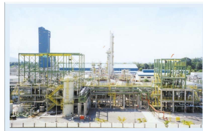
TSL 合成ゴム製造設備
