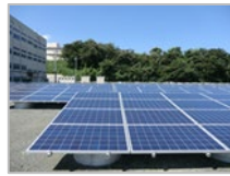
太陽光発電所
