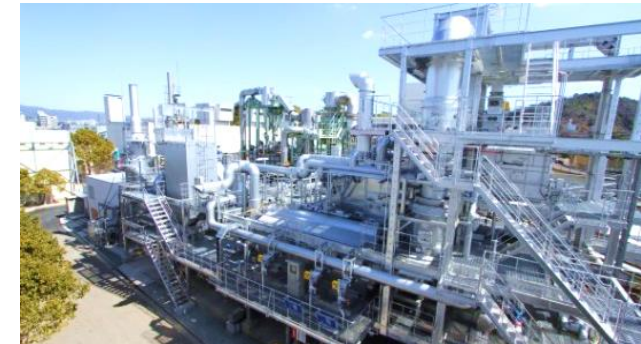
下水汚泥焼却発電プラント
