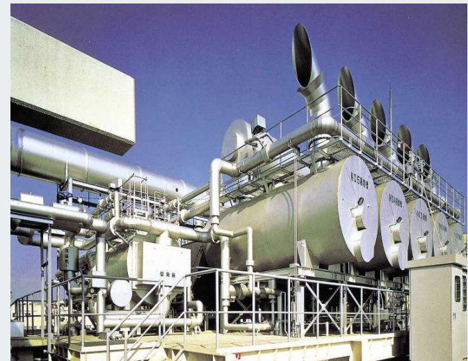
<環境保全設備>
