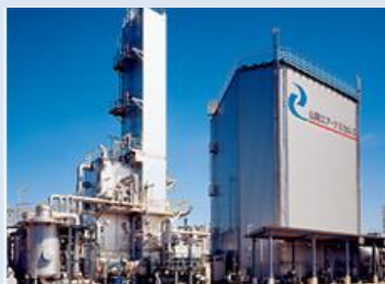
ガス製造プラント
