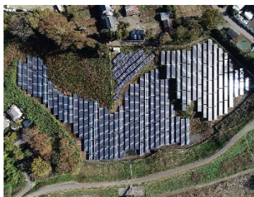
S-17 茨城坂東太陽光発電所 [1,164kW/399百万円]
