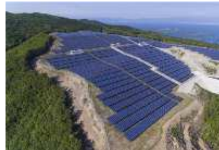
S-06 長崎琴海太陽光発電所
