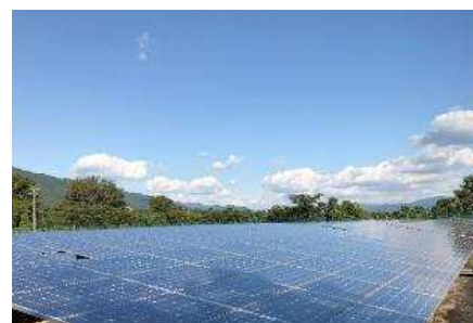
S-08 新城太陽光発電所
