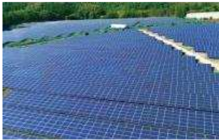
S-05 銚田太陽光発電所
