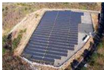
S-04 JEN玖珠太陽光発電所
