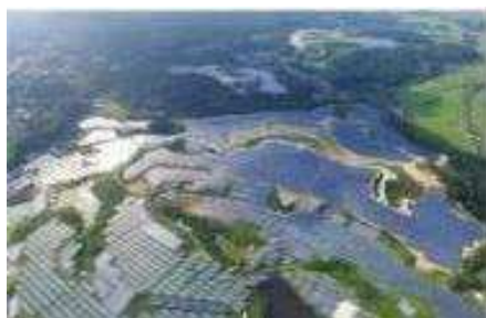
S-01 高萩太陽光発電所
