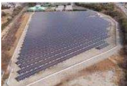
S-03 JEN防府太陽光発電所
