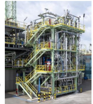
導入されたQpinch設備 (所在:ベルギー、アントワープ) 写真: ©2021 Borealis.
