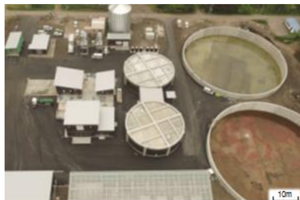
バイオガスプラント
