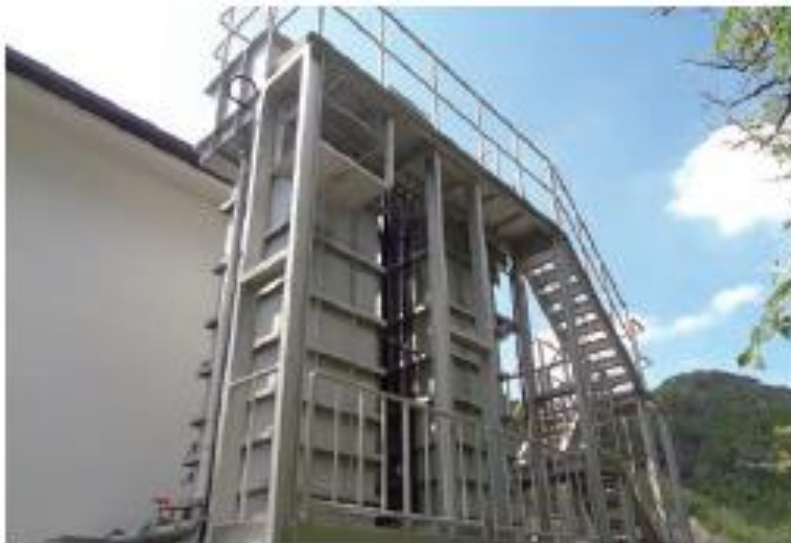
東京都小笠原村沖村浄水場(母島) (令和2年度稼働)
