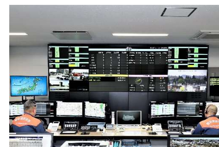
消防・救急通信指令システム
