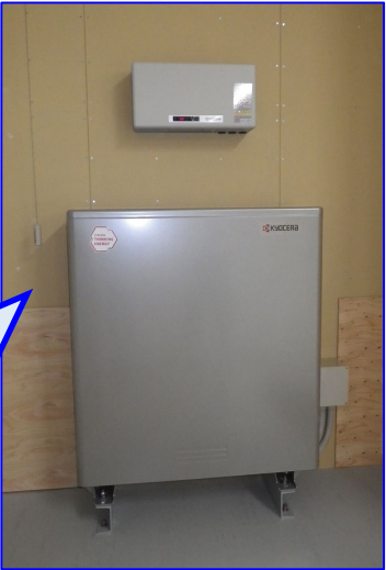
〈太陽光連動型リチウムイオン蓄電池(六地藏店)〉
