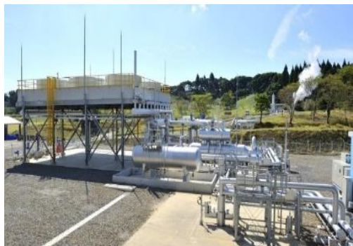
【メディポリス指宿地熱発電所】
