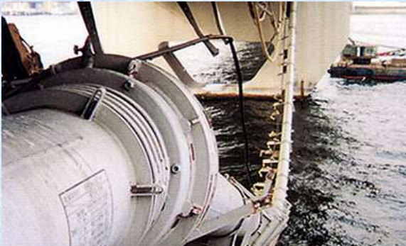
▼写真①:六甲大橋から落下した水道管
