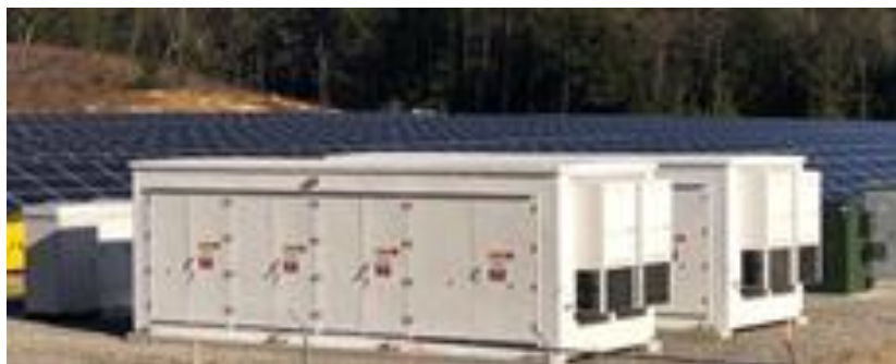
IHI Terrasun Solutions Inc.が提供する Energy Storage Management System
