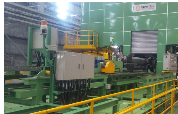
第2冷延ミル ロール組み替え装置
