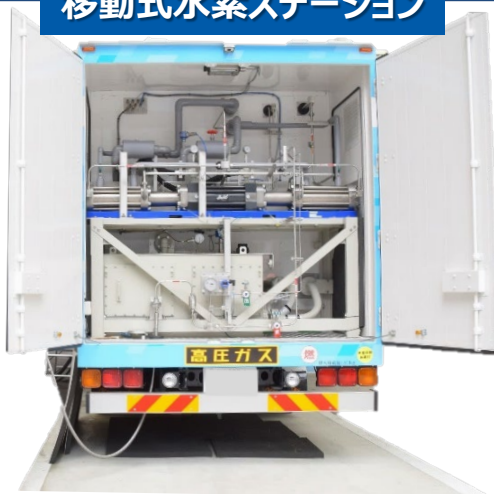
水素ステーション車に搭載された 高圧型水素圧縮装置
