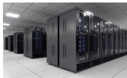
高効率電源 (サーバー等)
