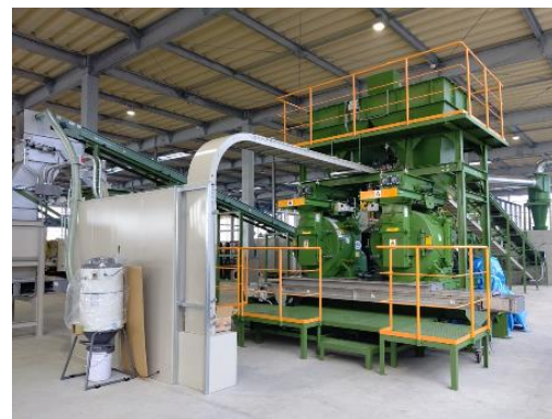
畜糞ペレット製造設備
