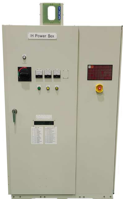
高周波電源装置
