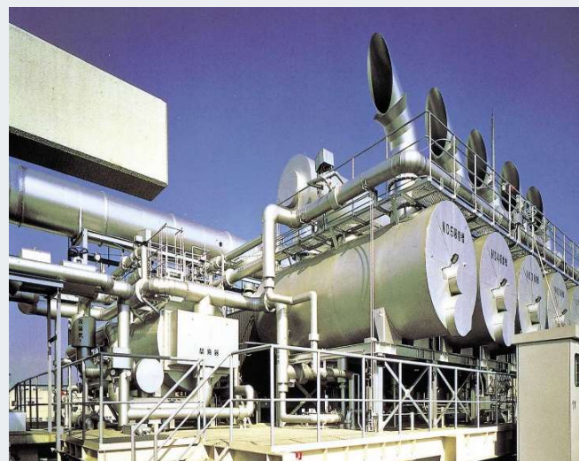
<環境保全設備>
