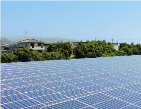
コンパクトソーラー発電所
