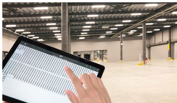
センサー付LED照明の導入
