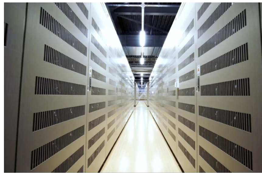
*1 蓄電池システム内観
