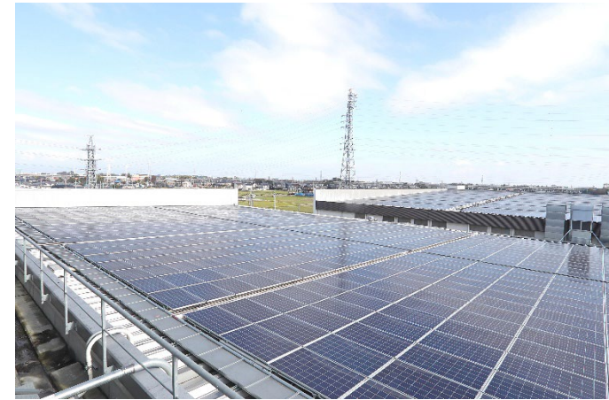
鴻巣研究所3号棟屋上の太陽光パネル
