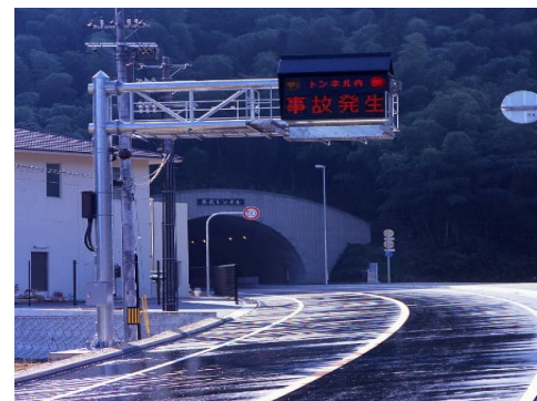
トンネル警報表示板 (トンネル防災システム)
