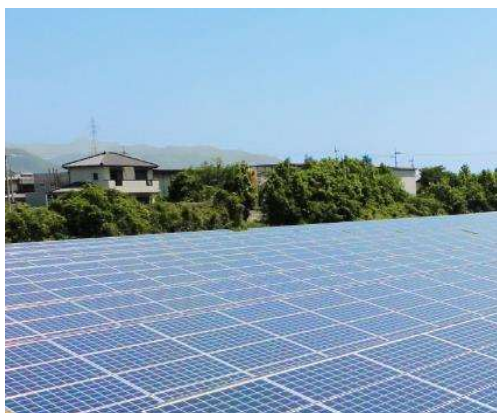
コンパクトソーラー発電所
