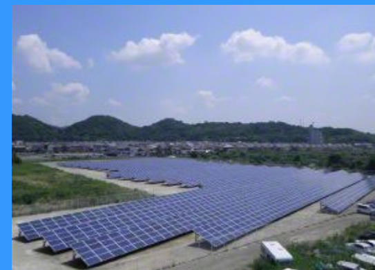
大塩第一太陽光発電所
