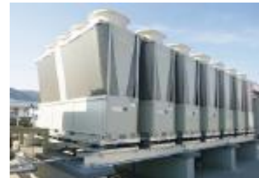
現在導入を進めている電気式空調設備
