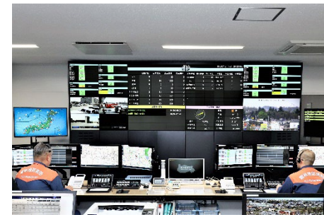
消防・救急通信指令システム
