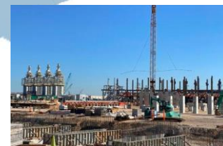
Courtesy of Golden Pass LNG
