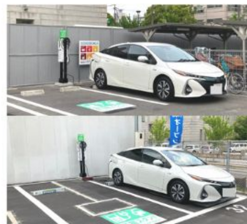
大阪府・エコロシティ株式会社 (大阪府庁駐車場内4基)
