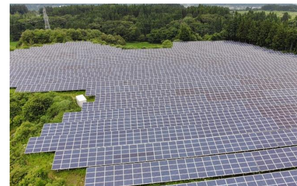
TESS秋田河辺ソーラー発電所
