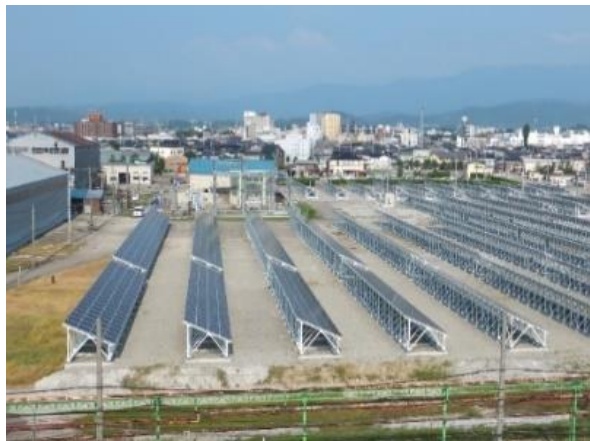
魚津工場に設置された太陽光パネル
