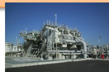
オープンラック式LNG気化器
