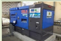
水素混焼 発電機*
