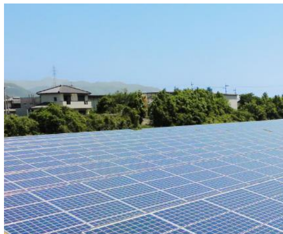
コンパクトソーラー発電所
