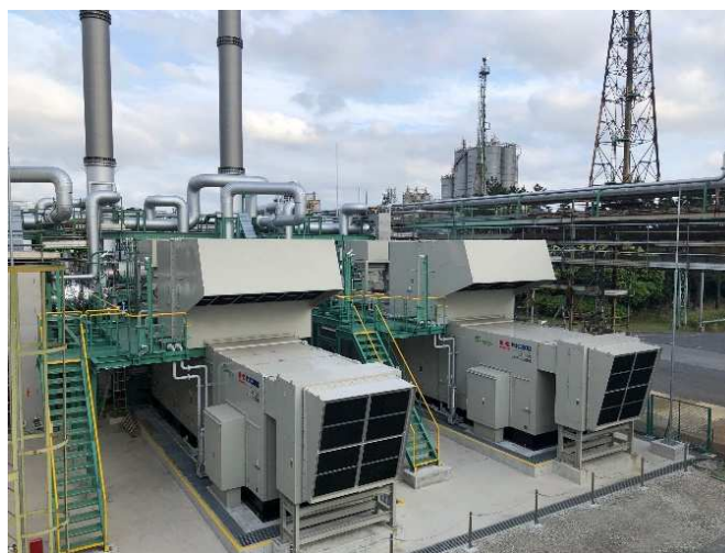
<竣工した高効率ガスタービン発電機>
