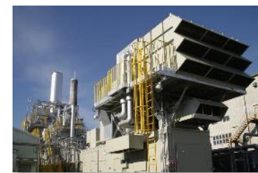
水素混焼 コージェネレーションシステム
