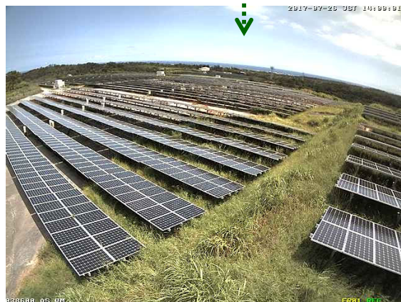
WEBカメラによる発電所の様子
