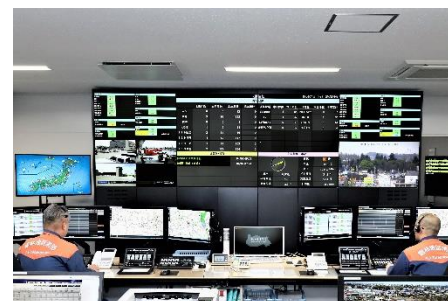
消防・救急通信指令システム
