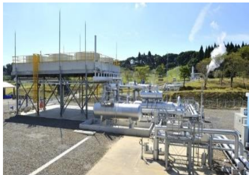
【メディポリス指宿地熱発電所】
